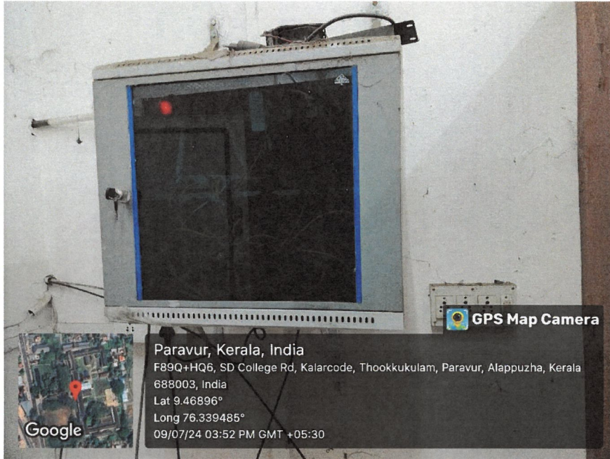
LAN Switch - Office
